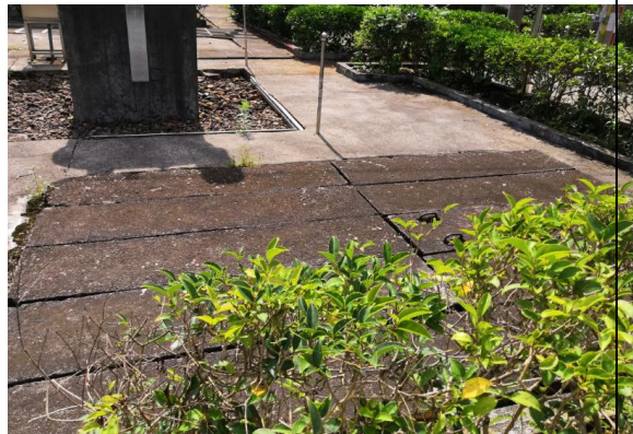
110kV 天台变电站事故油池
