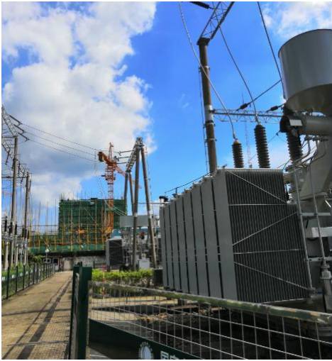
110kV 天台变电站现有主变
