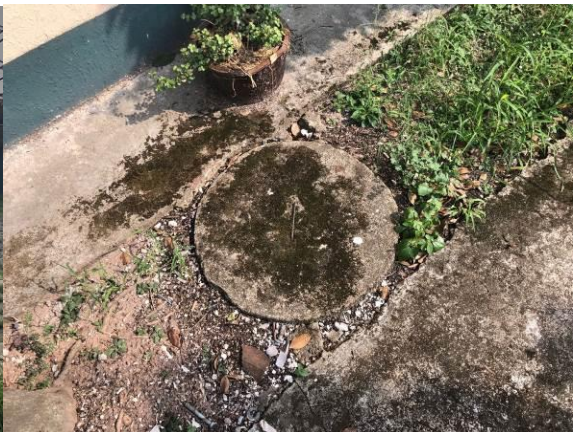
污水处理设施
