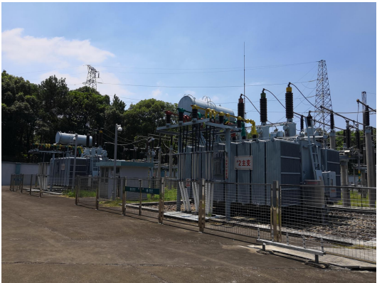
110kV 湖海塘变电站现有主变
