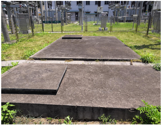
110kV 湖海塘变电站事故油池
