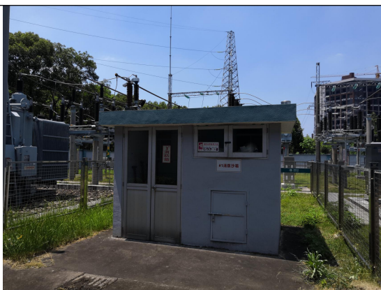
110kV 湖海塘变电站主变消防室
