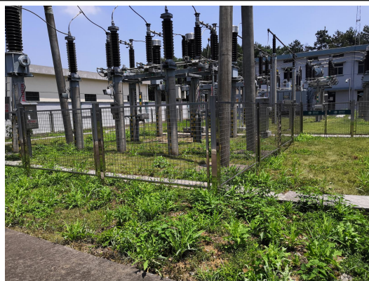
110kV 湖海塘变电站站内绿化
