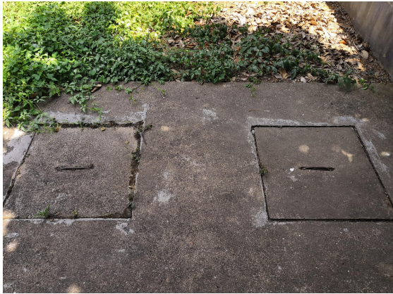
110kV 湖海塘变电站污水处理设施
