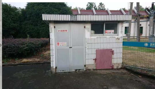
110kV 高塘变电站主变消防器具
