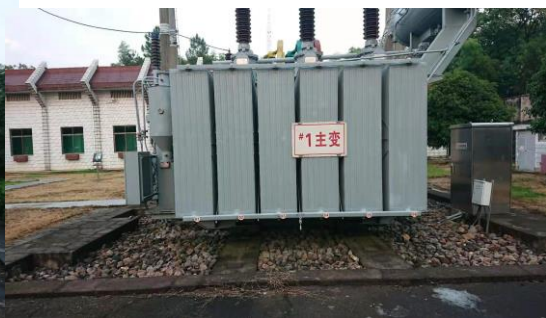
110kV 高塘变电站现有主变
