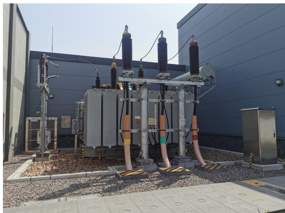
图 6-1 1#主变及下方油坑
