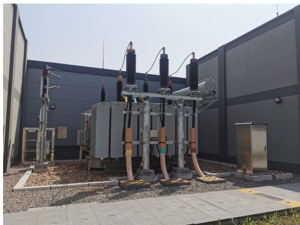
图 6-2 2#主变及下方油坑
